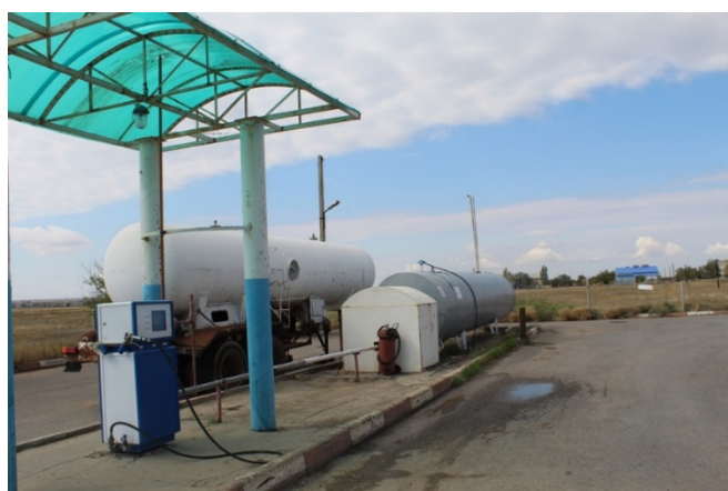
Фото 2. Газозаправочная станция, Кетченеровский район.
