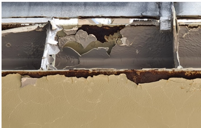
Изображение №3: Отслоение огнезащитного покрытия. Различие слоев покрытия
