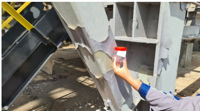
Изображение №2: Отслоение огнезащитного покрытия. Различие слоев покрытия
