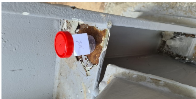
Изображение №4: Отслоение огнезащитного покрытия. Забор материала
