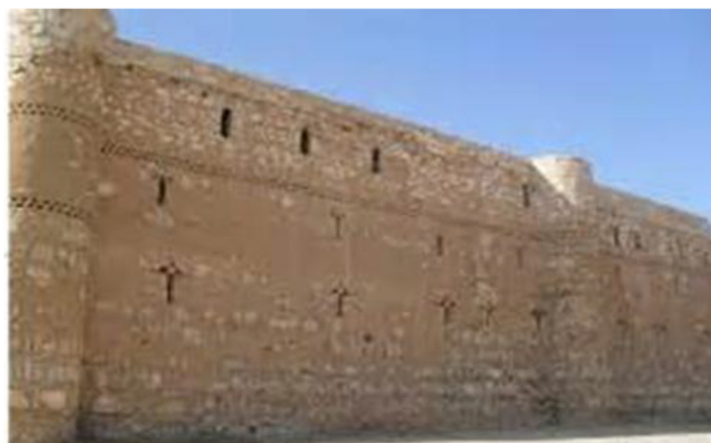
Рис.7. отверстия в стене
