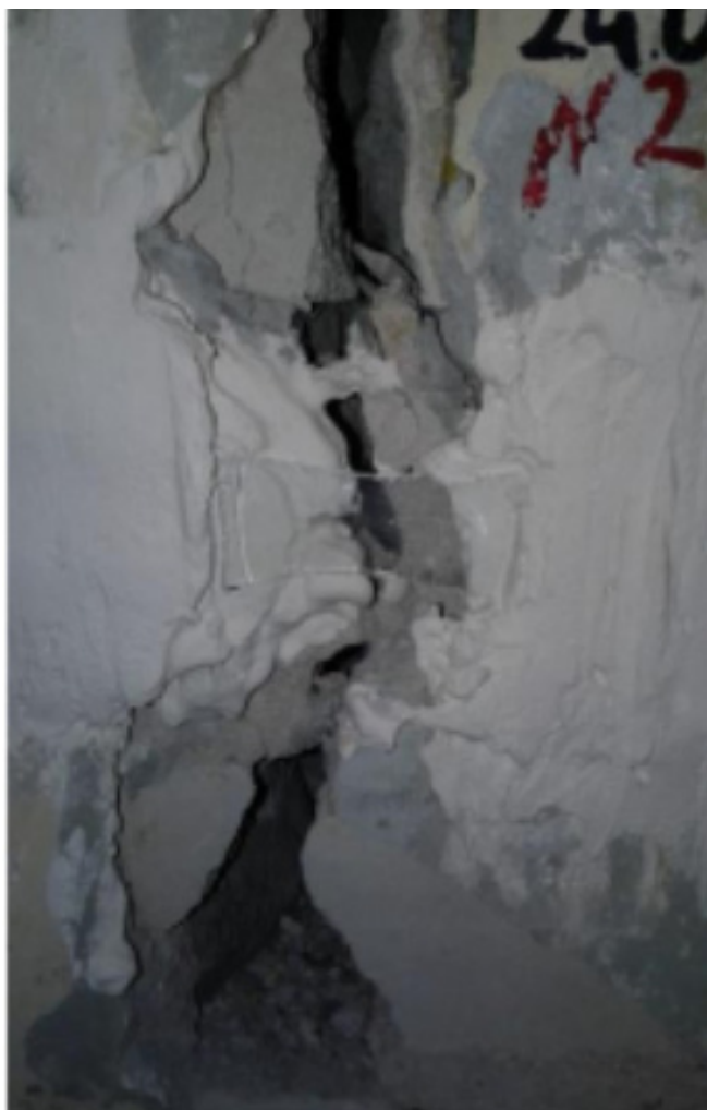
Рис.3. Сквозные трещины в несущих стенах
