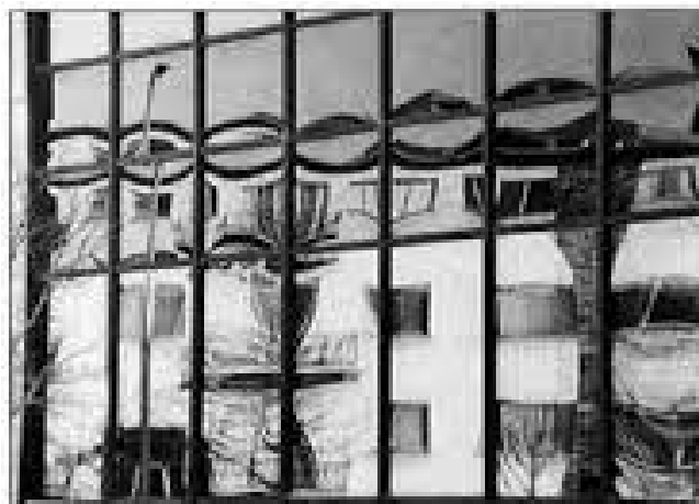
Рисунок 5 – Искривленные стеклопакеты на фасаде [18]
