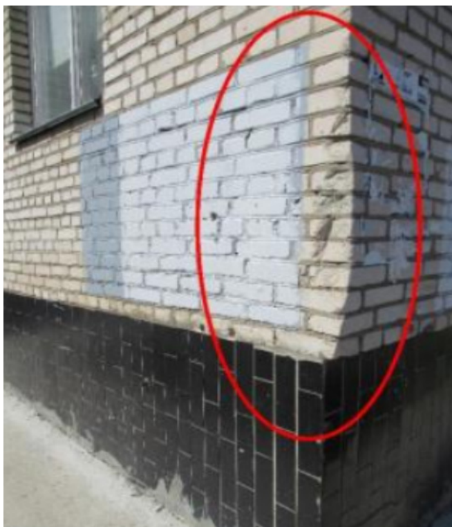
Рис.6. Трещины на фасаде здания
