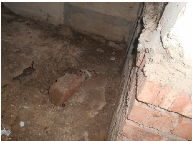
Рис.2. Провалы грунта в подвале
