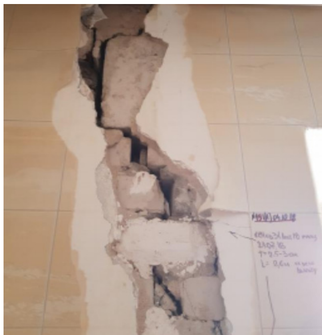
Рис.4. Сквозные трещины в несущих стенах
