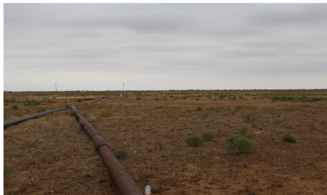
Фото 2. Водопровод в степи
