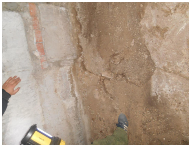
Рис.1. Трещины по стенам подвала
