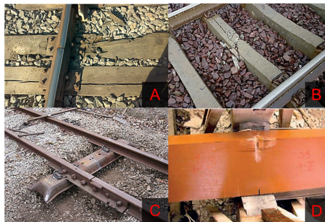
Рисунок 1 Виды дефектов шпал, изготовленных из различных материалов; (А) деревянная шпала (гниль), (В) бетонная шпала (разрушение при изгибе), (С) стальная шпала (коррозия) и (D) композитная шпала (удар).
