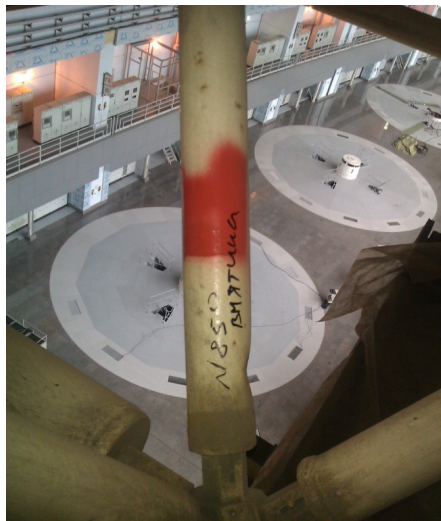
Рисунок 2. Подлежащий замене стержневой элемент с указанием дефекта и цветовой маркировкой
