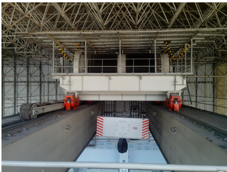
Рисунок 5. Общий вид смонтированной на каретке полукозлового крана разгрузочной системы
